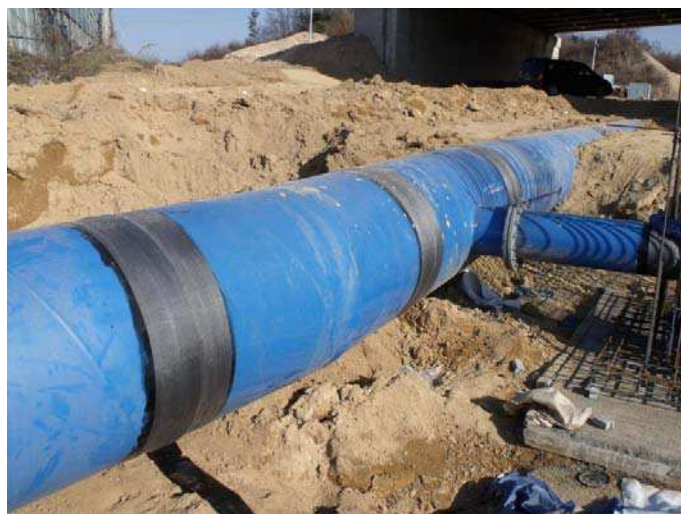
L'utilisation d'une machine pour la pose du revêtement permet d'obtenir une tension bien plus élevée. La résistance du revêtement aux contraintes mécaniques du sol sera ainsi renforcée.
